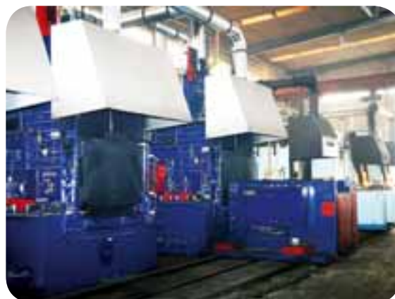
Pieco do procesu obróbki cieplnej
